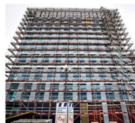
An der Glasfassade fehlen noch die Fotovoltaik-Elemente.
